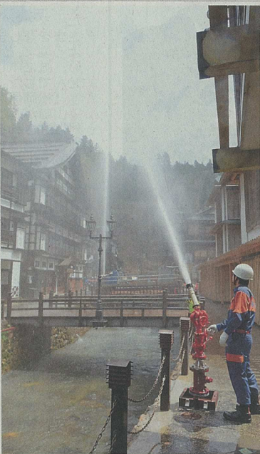
火災に備えて放水銃が設置された尾花沢市・銀山温泉
